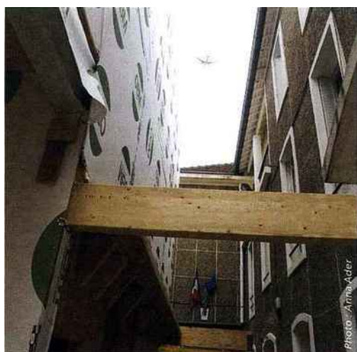
▲ Décalé de 3 m du bâtiment existant, le restaurant y sera relié par une passerelle.
