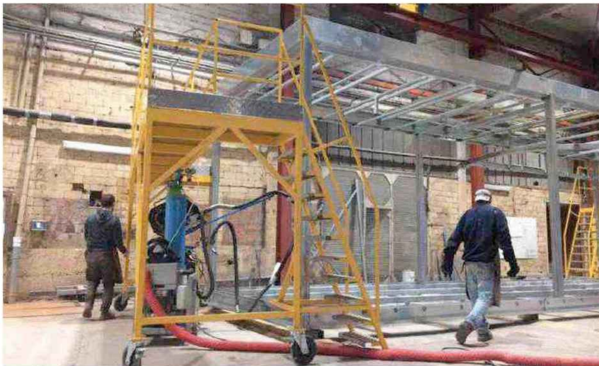
Un nouveau pont roulant a été installé : il permet de soulever 6,3 tonnes et de réaliser des projets plus importants en hauteur. (P.H.E.B.)
