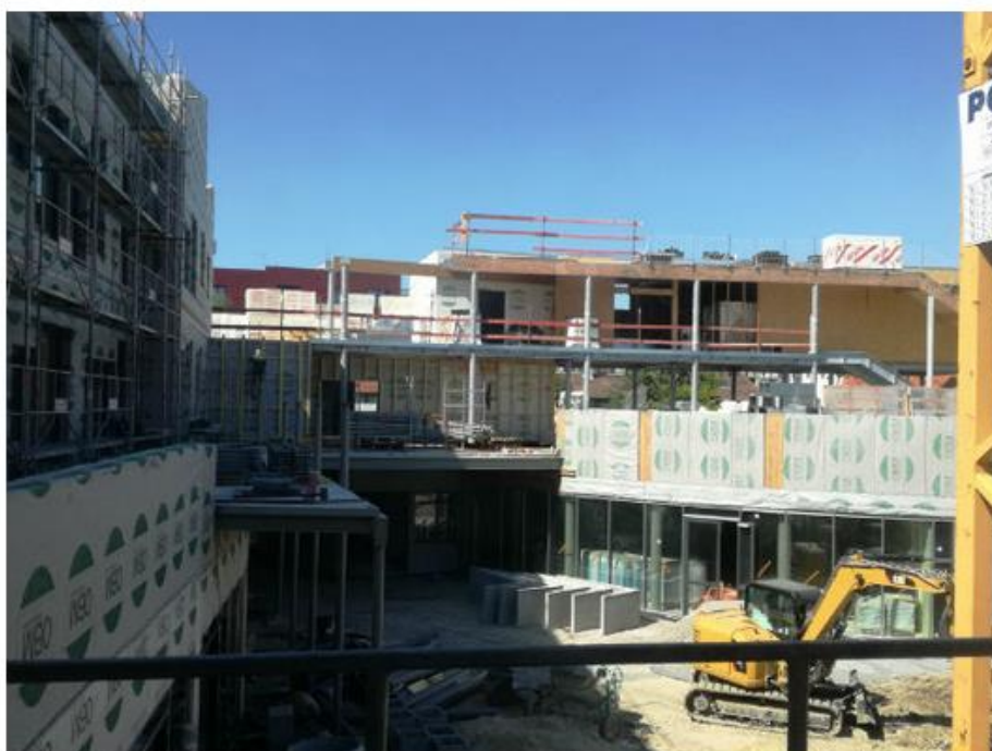
Vue arrière du bâtiment avec en bas la cour des élémentaires et la bibliothèque ainsi que le restaurant tout en baies-vitrées. Au-dessus, la cour des maternelles. ©DR
