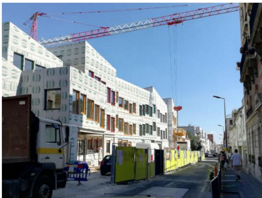
Construit par OBM et imaginé par l'architecte Monique Labbé, le groupe scolaire Marceau est un exemple en matière d'établissement écoresponsable pour la ville de Montreuil. ©DR
